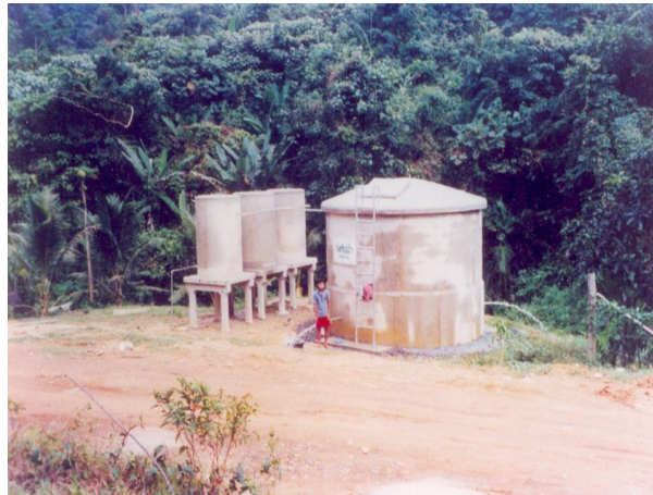
ถังกรองน้ำ - ถังเก็บน้ำ
